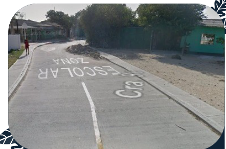
Actual estado de la vía en la carrera 9c entre calles 75 y 77
